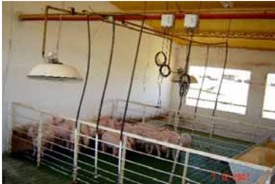
Foto Nº 3. Confinamiento. Interior. Fuente de calor (gas)
